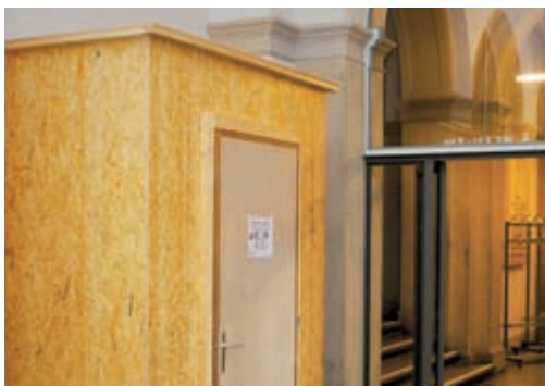
Die Toiletten im HG südlich der Halle werden erneuert. (Bild Niklaus Salzmann/ETH Zürich)
